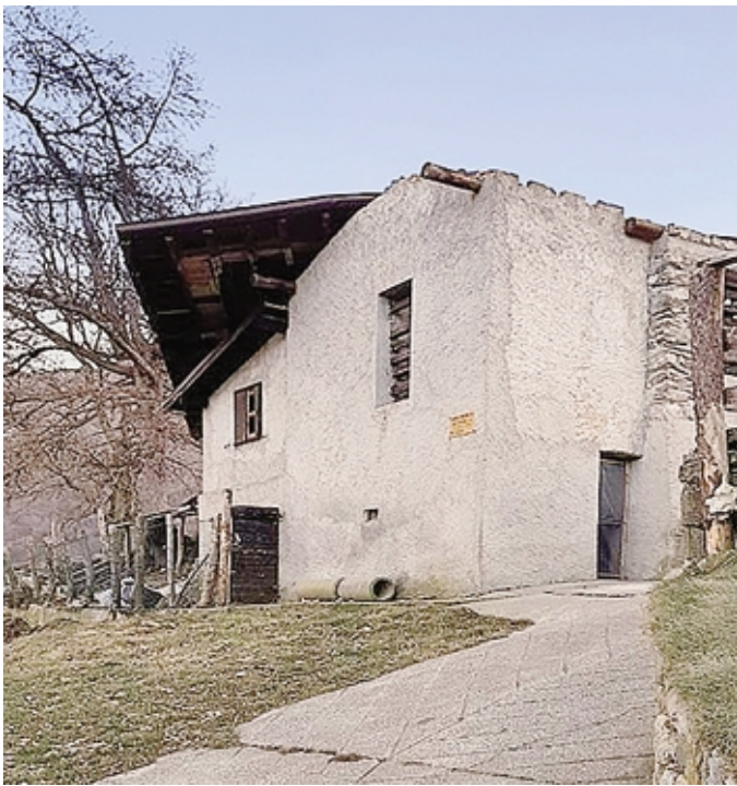
Il tetto dell'alpeggio è «scivolato» a causa del vento
