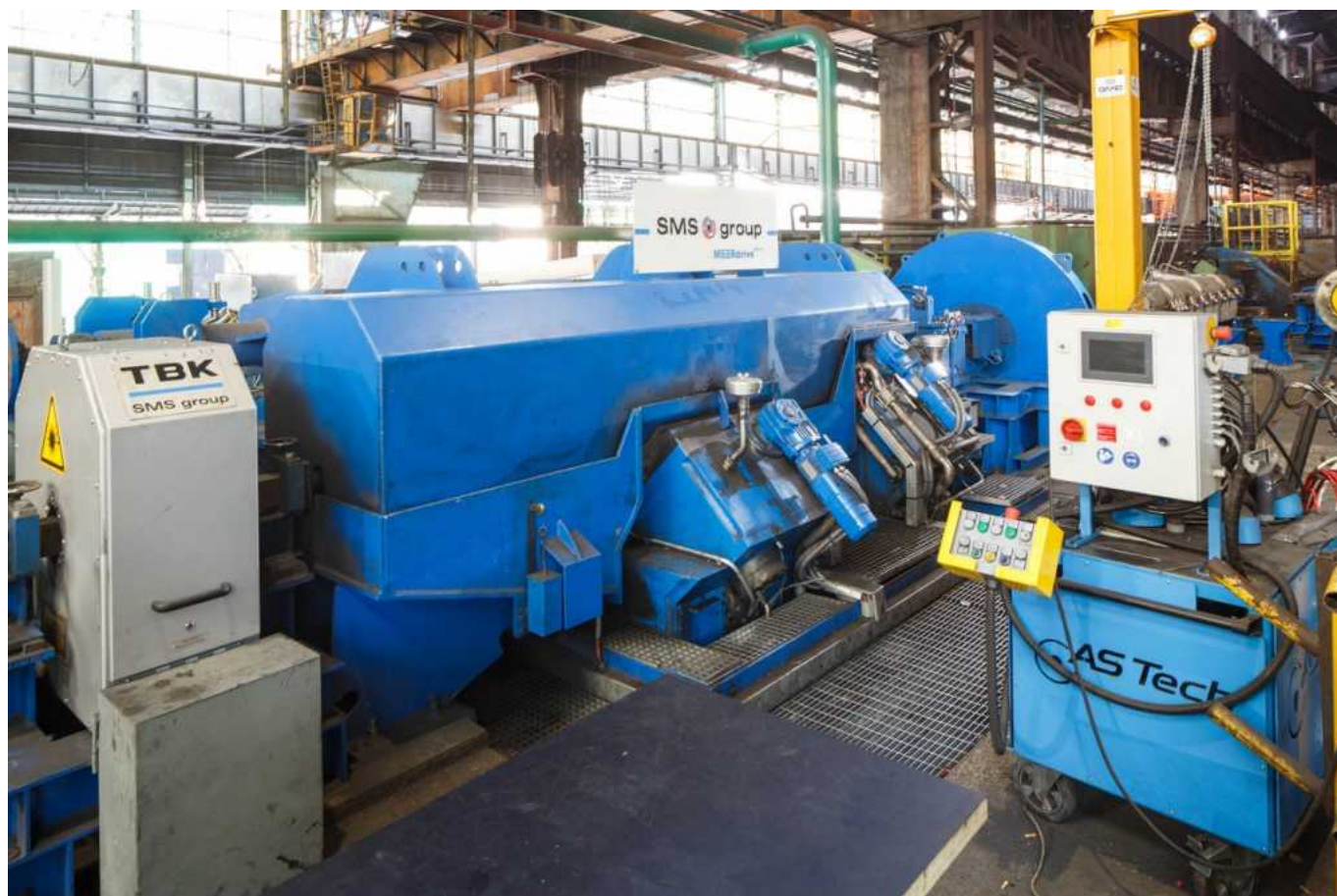
Il nuovo calibratore installato all'Arlenico
